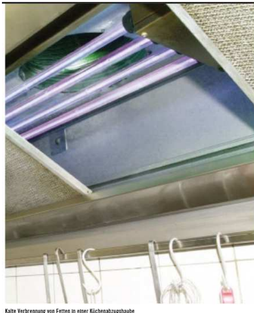
Kalte Verbrennung von Fetten in einer Küchenabzugshaube
